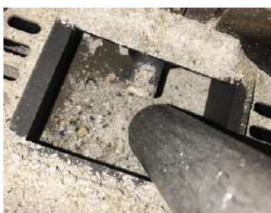
Beispiel eines verschmutzten Bodens
