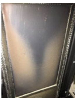
Antes de la limpieza
