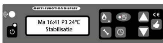
LAAG VERMOGEN P3
