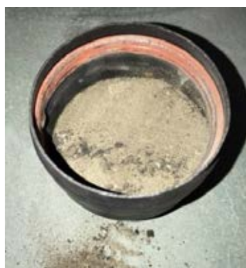
Beispiel eines verschmutzten Deckels
