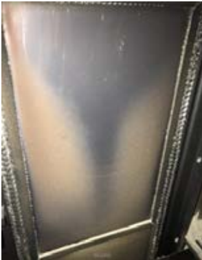
Beispiel einer verschmutzten Scheibe
